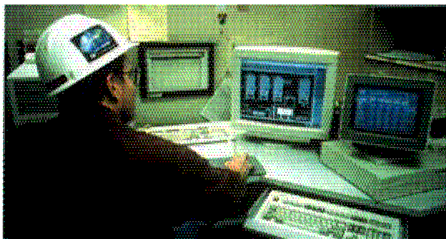
Fig. 7.9.- Centro de supervisión y control central.
