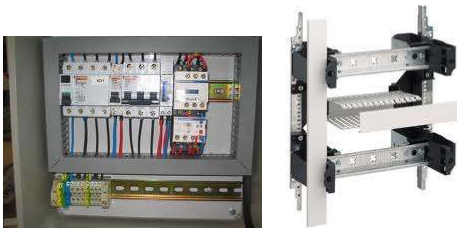
Fig.9. Armario eléctrico industrial donde se distingue, carril din, bornes, elementos de protección y control y canaletas.
