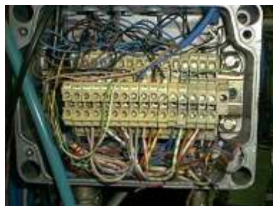
Fig.14. Regletero de conexionado
